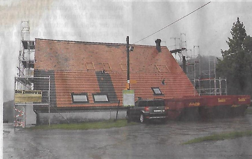
Die schwierigen Witterungsbedingungen der vergangenen Wochen erschwerten die Arbeiten am Berggasthaus Rossberg.
